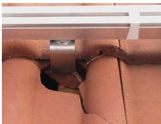
Erreur de montage = tuile cassée
